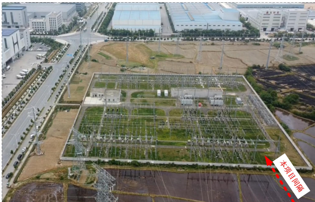
图 2-6 220kV 石岗变 220kV 间隔现状
