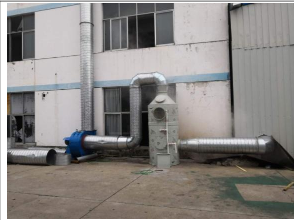
调胶/涂胶/热压废气治理-喷淋塔-DA001
