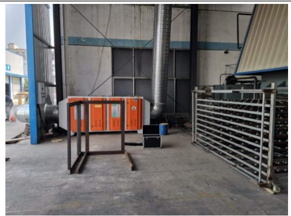
调胶/涂胶/热压废气治理-UV 光养设备
