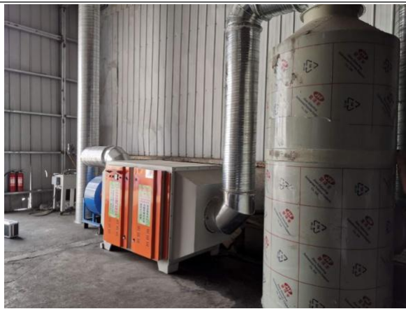
制胶废气治理-喷淋塔+UV 光养-DA007
