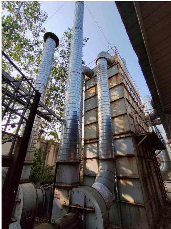
锯边/砂光/斜磨/纵横锯粉尘-1#除尘器-DA002
