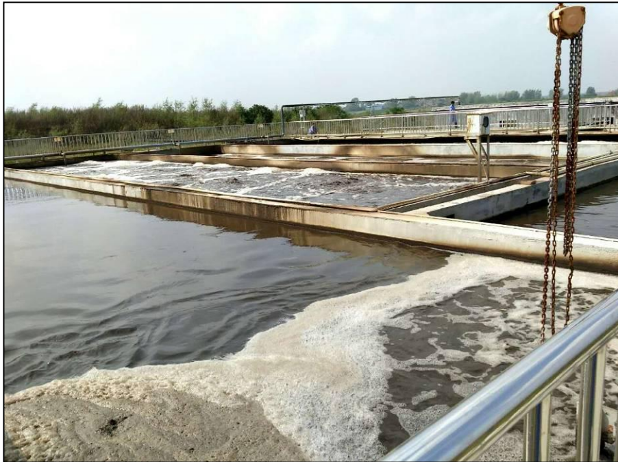
图 6.2-6 滁州温氏畜牧养殖有限公司废水处理站
