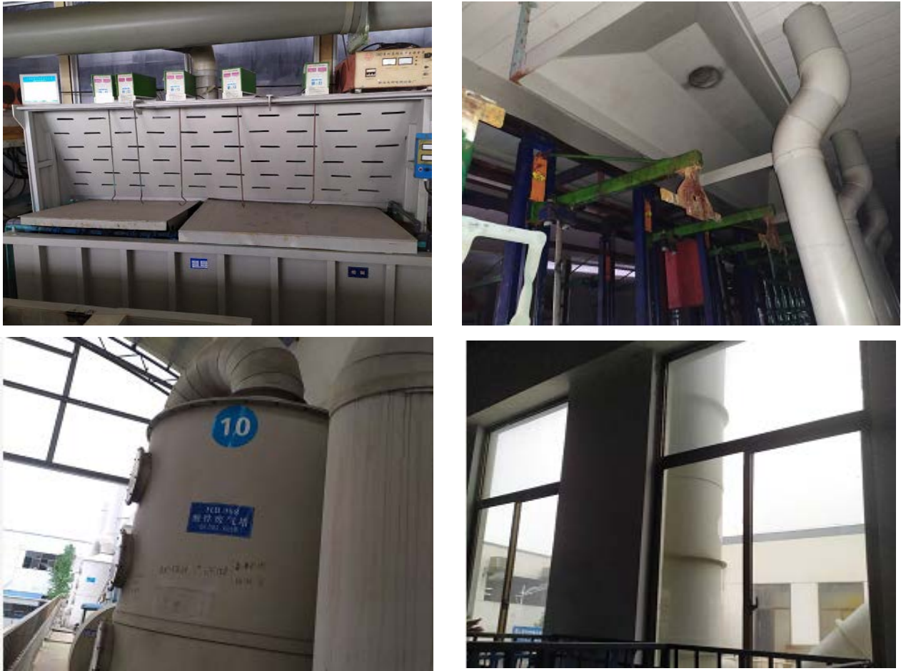
图 3.5.2-1 废气处理工程实景
