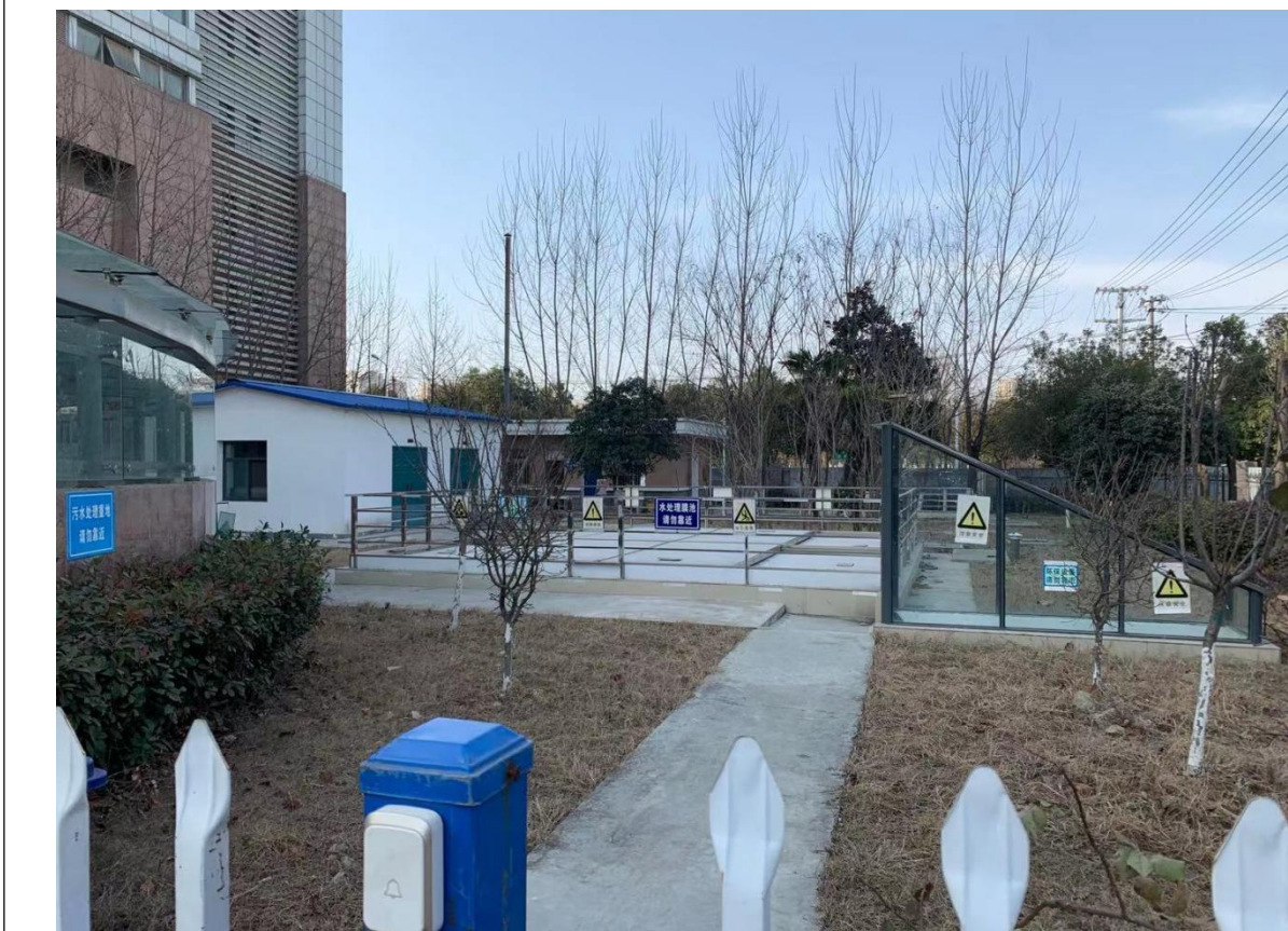
皖西卫生职业学院附属医院医疗废水处理站
