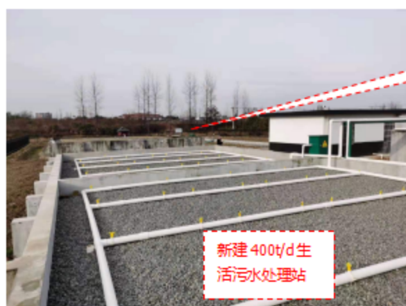
图3 新建污水处理站处理设施
